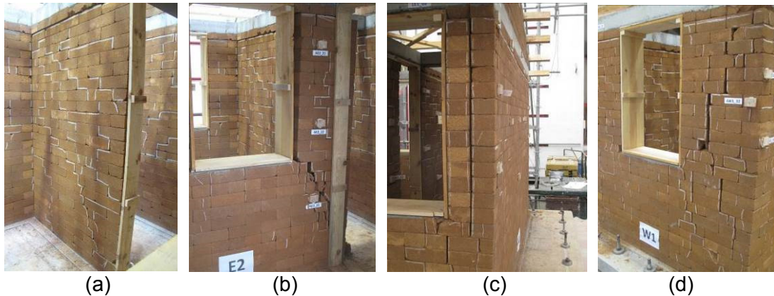
Figura 4. Padrão de fendilhação: a) parede interior; b) nembro/pilar da fachada Este; c) cunhal Sudeste; e d) cunhal Sudoeste.
