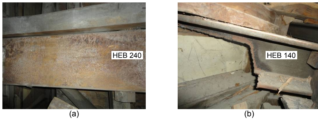
Figura 4 – Pormenores da estrutura metálica: (a) corrosão no banzo superior dos perfis HEB 240 (vista superior); (b) corte da secção transversal do perfil HEB 140.
