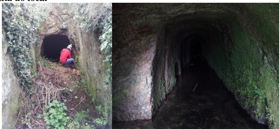
Figura 53: Imagem da esquerda entrada do LIG Mina de Corujas; à direita o interior da galeria.
