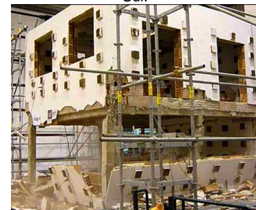
f) Fase que antecede o colapso da estrutura.
