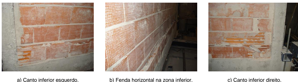
Figura B 36 - Dano observado na zona inferior do painel desconstruído Wall_RAR_01.
