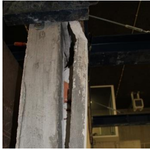
a) Colapso da forra.
