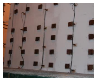
c) Acelerómetros nas paredes de preenchimento.
