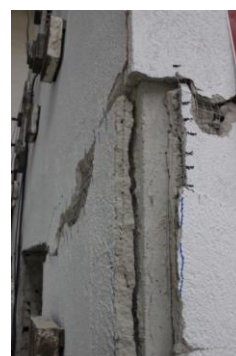
c) Destacamento do reboco no cunhal Noroeste.
