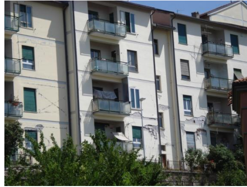
b) Danos no plano da parede.
