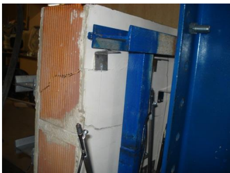
a) Corte e flexão no provete PJHA2.
