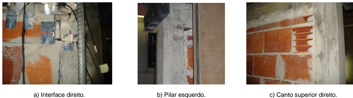
Figura 7.18 - Fendilhação observada no painel Wall_REF_01.
