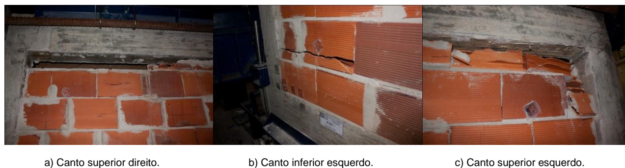
Figura 7.23 - Fendilhação observada no painel Wall_REF_01.
