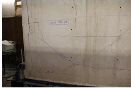
b) Fendilhação na zona central.
