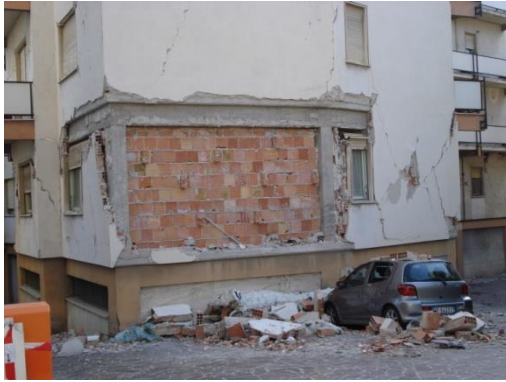
a) Colapso para fora do plano da parede.
