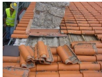
Figura 2-18| Demolição da argamassa de cimento existente sob os beirais e nos remates em empena
