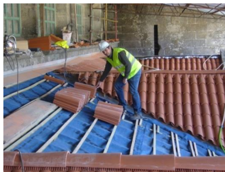
Figura 2-6 | Aplicação de ripado e contrariado em madeira de pinho tratado, para fixação da telha cerâmica, igual à existente, armada com grampos em inox e a aparafusada ao ripado
