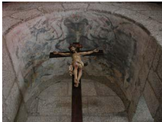
Figura 2-17 | Infiltrações no nicho do altar em pedra
