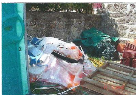
Figura 2-40 | Desorganização no estaleiro / entulho
