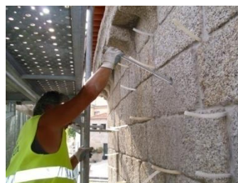
Figura 2-29 | Execução do tratamento das fissuras existentes nos paramentos da nave, nas fachadas Poente, Sul, e Nascente do seguinte modo: aplicação de varões ou barras em aço inox, injeção de um consolidante tipo "Lime Injection" da "Tecnocrete", tratamento final para as juntas
