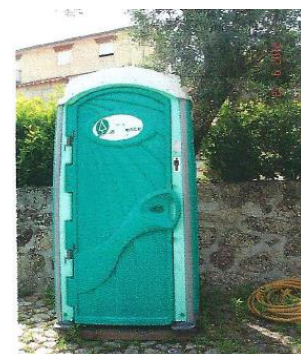
Figura 2-41 | Instalação sanitária no estaleiro
