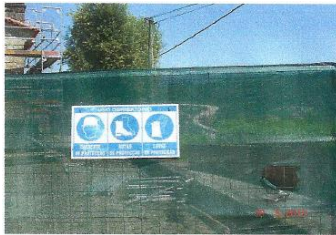
Figura 2-37 | Sinalização incompleta na entrada do Estaleiro, falta de sinal de proibida a entrada a pessoas estranhas em obra e perigos vários
