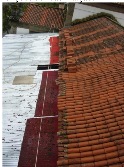
Figura 2-10 | Utilização de linhas de Vida e Passadeiras antiderrapante conforme especificações técnicas do PSS
