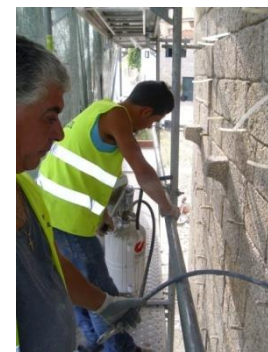
Figura 2-22 | Injeção nas juntas, pregagens, incluindo as feridas provocadas por peças metálicas eventualmente removidas, seu refechamento em profundidade. A estas argamassas será adicionado um produto hidrófugo.
