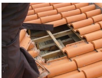
Figura 2-19| Remoção de todos os elementos cerâmicos existentes nas coberturas, incluindo rufos e caleiros,
