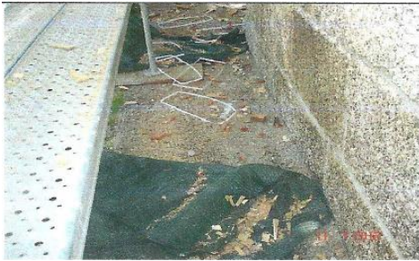
Figura 2-35| Verificou-se que o andaime tinha um afastamento relativo a fachada, muito superior a distância regulamentar entre 0,45 e 1m relativamente ao lado interior do andaime relativos a todos os níveis do mesmo. Verifica-se então um risco de queda em altura.
