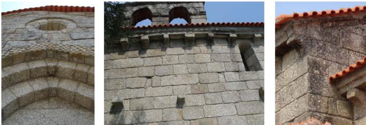
Figura 2-16 | Fissuras na Fachada principal/Fissuras na fachada Sul do Campanário/Fissuras na fachada Este da Nave
