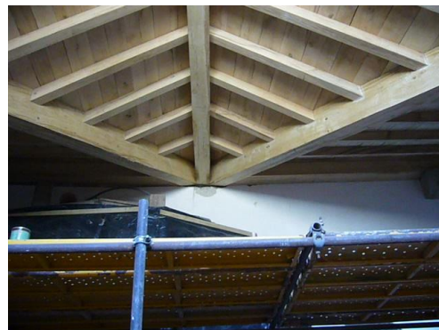
Figura 2-5 |Execução de estrutura nova de cobertura da sala anexa ao coro-alto, em madeira de carvalho nacional constituída por vigas com 16x26cm, de acordo com o Parecer Técnico do Instituto da Construção da FEUP
