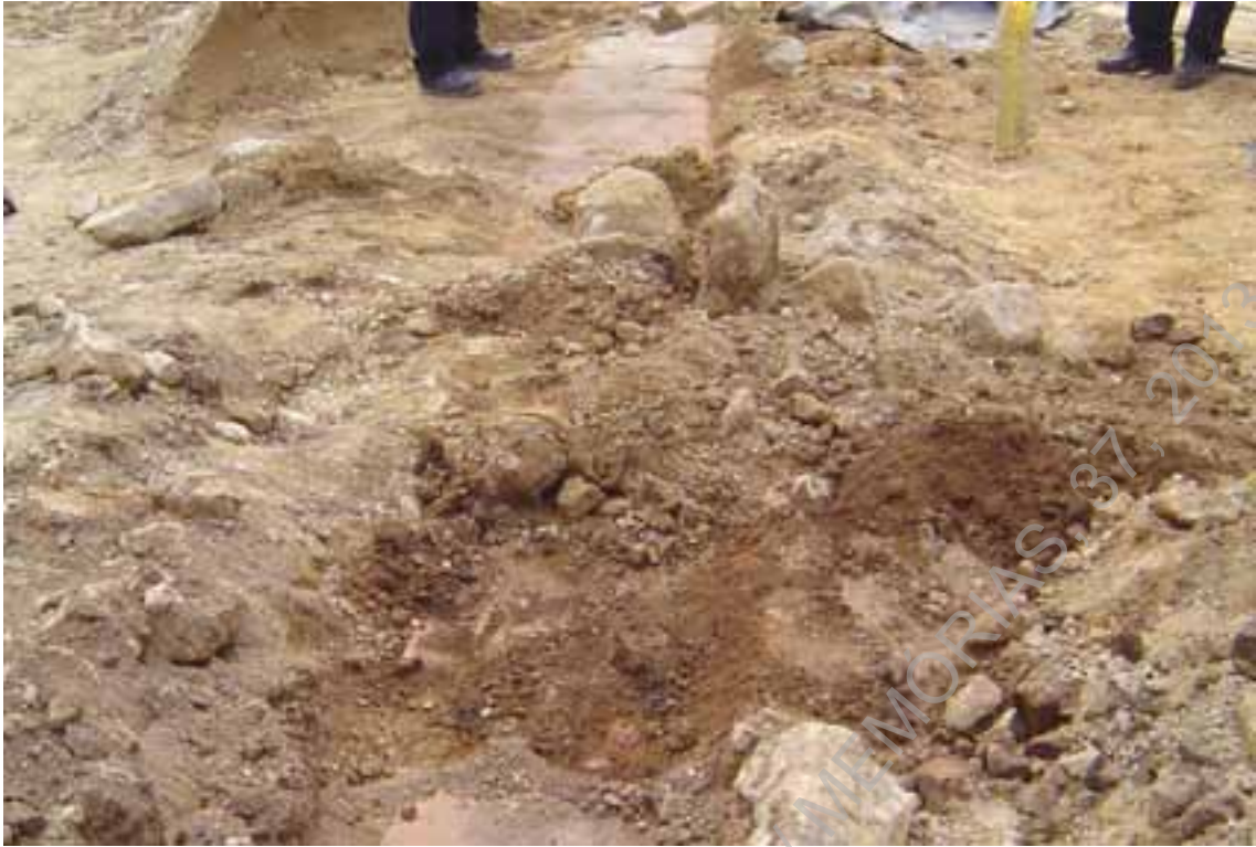
Foto 1 – Estado da canalização, aquando da descoberta por parte do empreiteiro responsável pelas obras.
