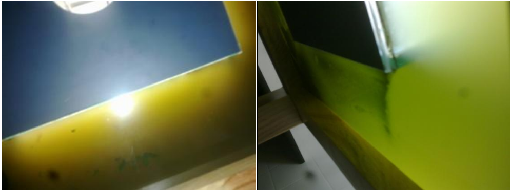
Ilustração 101 e 102- Fundo do depósito com acumulação de biomassa; Fundo do depósito com marcas de arrastamento da biomassa do fundo do depósito.
