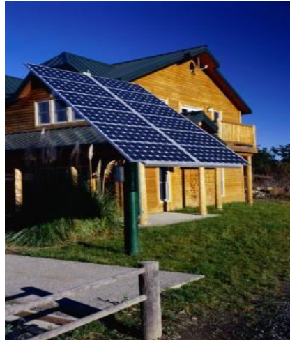
Fig. 80 Aplicação de painéis foto voltaicos em suporte independente
