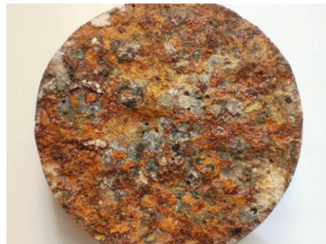
Figura 13. Superfície de fratura após macro-fissuração e destacamento do betão devido à corrosão das fibras de aço no BRFA.
