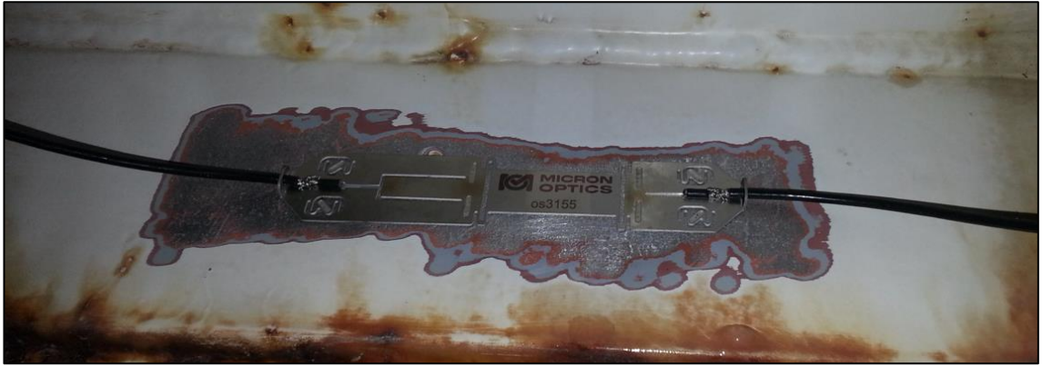
Kuva 10. Ahvenkosken maantiesillan pääkannattajan alalaippaan kiinnitetty FBG-valokuituanturi, tyypiltään Micron Optics 3155 (Lyöri 2014).
