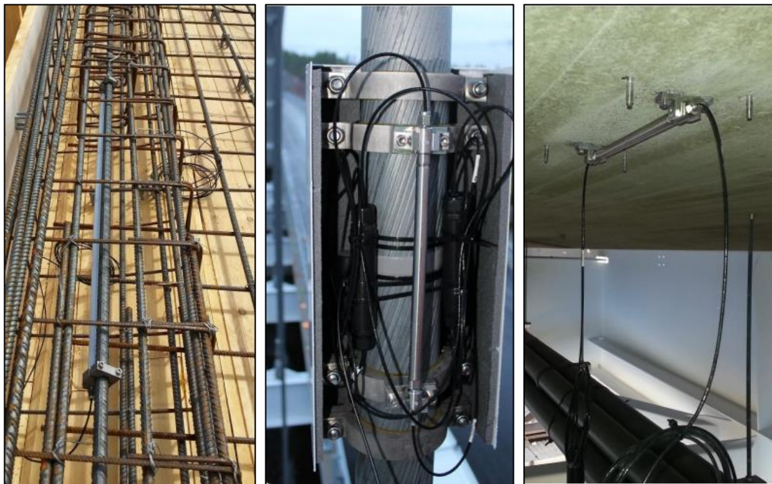
Kuva 24. FBG-venymäänturien asennuksia. Vasemmalla betonirakenteen sisään reunapalkkiin asennettu anturi, keskellä vetotankoon ja oikealla betonikanteen asennettu venymäänturi (Dimense 2014).
