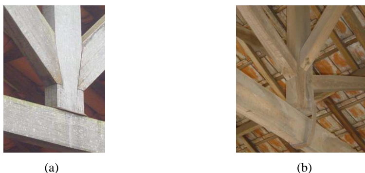
Figura 3 – Exemplos de ligações pendural-linha erradas; (a) Pendural pregado à linha; (b) Ligação rígida entre o pendural e a linha.
