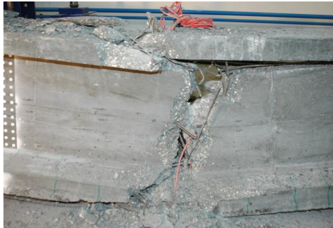
Figura 10 – Aspeto da zona de rotura no final do ensaio.
