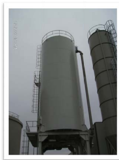
Figura 4.16 – Silo de lamas
