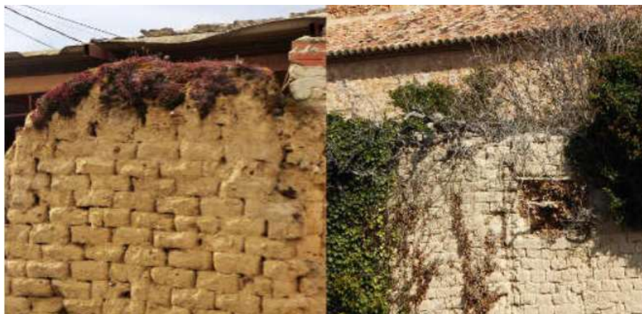
Figura 4. Crecimiento de planta en el muro de adobe. Fuente: https://bit.ly/3Lste77
