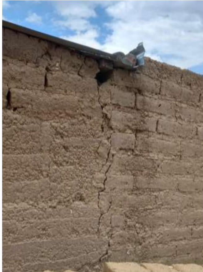
Figura 5. Muro de adobe con presencia de grieta vertical Fuente: Propia
