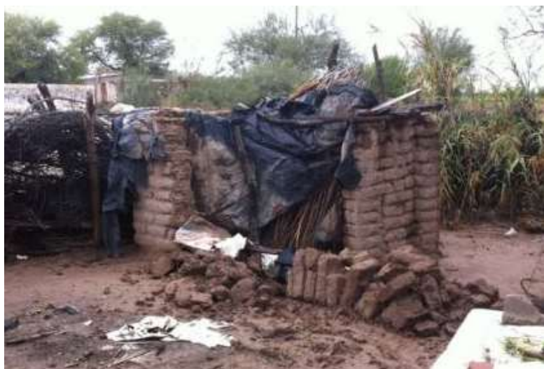
Figura 7. Muro de adobe perjudicado por las fuertes lluvias Fuente: https://bit.ly/3RZhLhD
