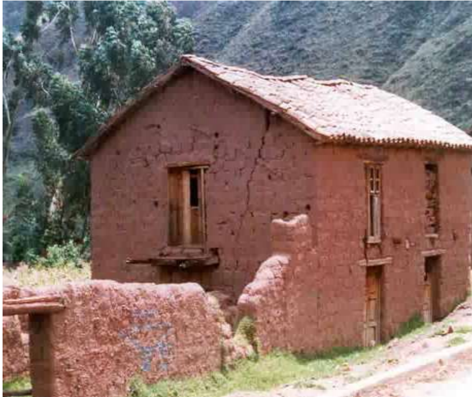
Figura 1. Baja resistencia de vivienda de adobe (agrietado) Fuente: https://bit.ly/3S23VLo
