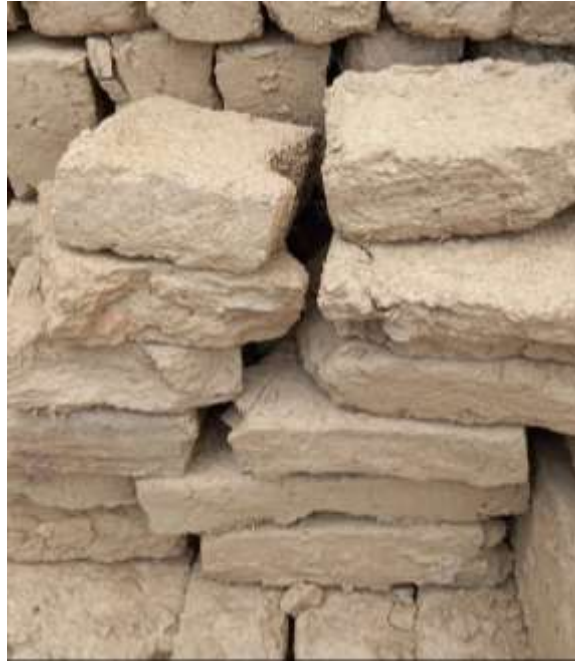
Figura 6. Presencia de deficiencia en el adobe Fuente: Propia
