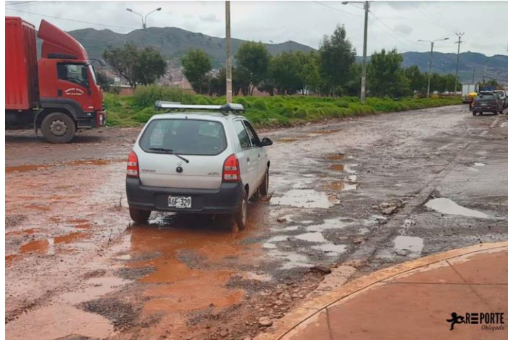
Figura 13 Vía en mal estado - Cusco
