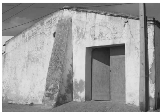
Figura 11 – Contraforte de uma construção em taipa de Vila Alva, no Alentejo [21].
