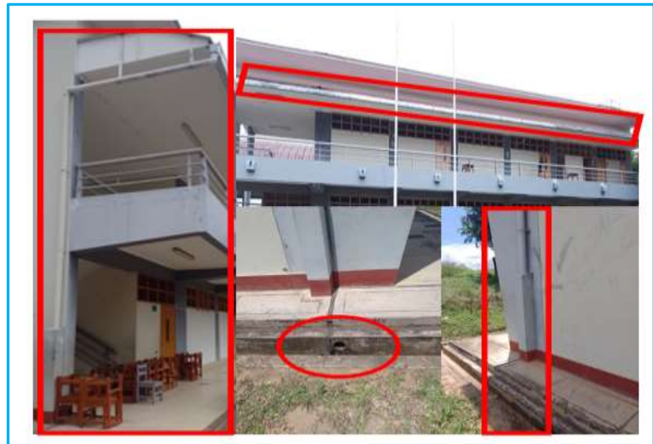
Figura 8. Sistema de Captación y Drenaje Pluvial.
