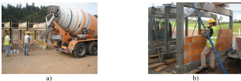
Figura 2 – Fases construtivas dos painéis: a) Betonagem dos pórticos; b) Construção das paredes.
