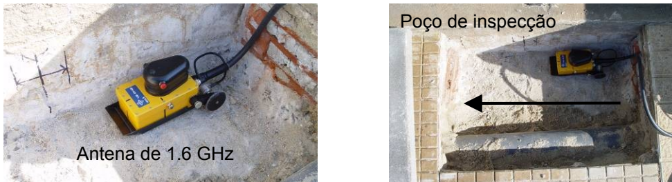
Figura 12. Inspeção para determinar a localização de barras pré-esforçadas embebidas no tabuleiro. Detalhe dos poços de inspeção realizadas uniformemente espaçados no passeio.
