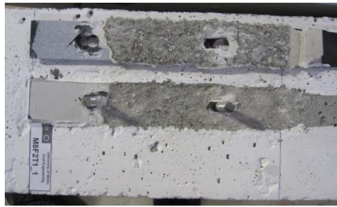
Figura 18 – Destacamento na interface adesivo/MDL para o provete M8F2S2T1_1.
