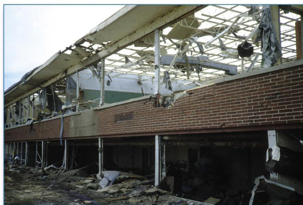
Figura 6.17.: Aspecto do estado de um edifício depois da passagem de um tufão 212 .
