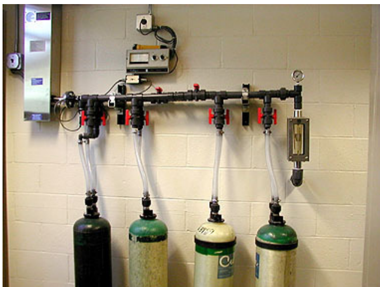
Figura 7.5.: Aspecto de uma rampa de gases 310 .
