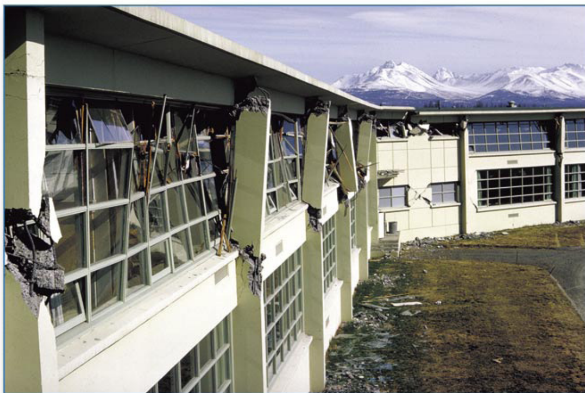
Figura 6.12.: Aspecto das fachadas exteriores de um edifício depois da ocorrência de um sismo 201 .
