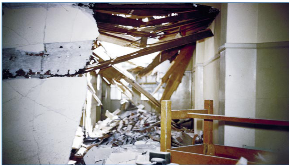
Figura 6.11.: Aspecto do estado do interior de um edifício após a ocorrência de um sismo 199 .
