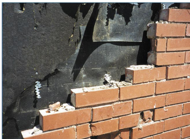
Figura 6.16.: Imagem de uma patologia grave devido à deficiente ligação entre os materiais de revestimento e acabamento das fachadas. 211
