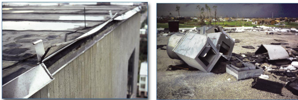
Figura 6.18.: Aspecto do estado de uma cobertura e dos equipamentos aí instalados depois de uma tempestade. 215
