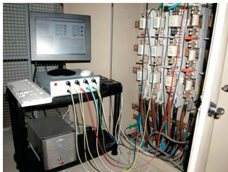
Fig. 2: Sistema de monitorización instalado.
