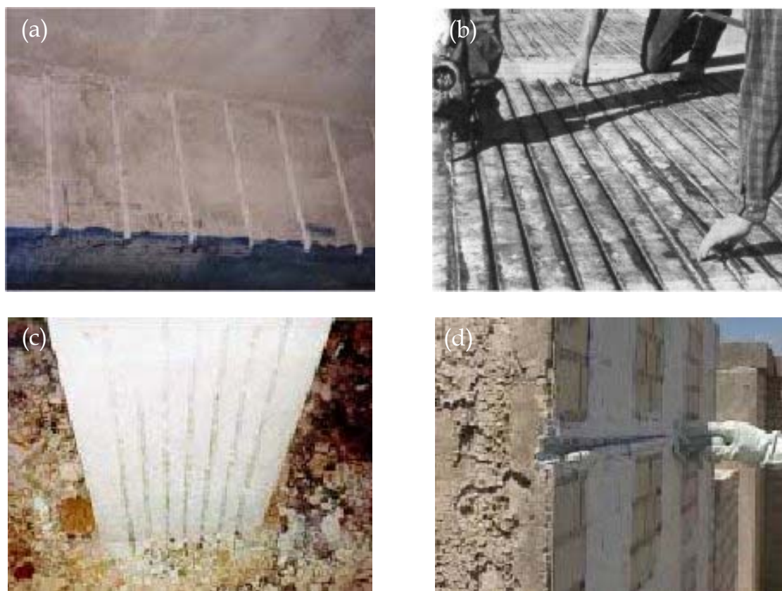
Figura 2 – Exemplos de reforço de estruturas com recurso a varões de CFRP inseridos no betão de recobrimento.
