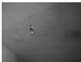
Figura 5: Manchas amarelas e esfarelamento da pintura de tecto.
