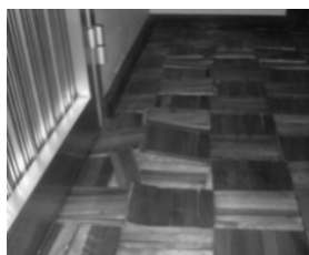
Figura 3: Levantamento do revestimento de madeira junto a porta da varanda.
