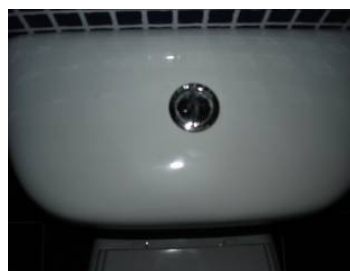
Figure 3.9. Double flush toilets (6/3 l).
