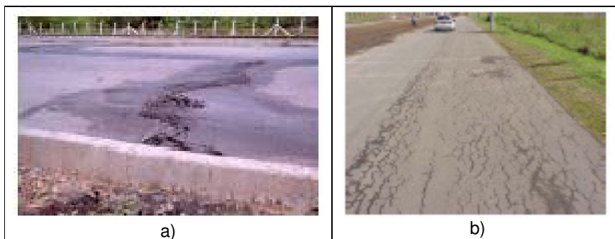
Figura 2.4: Pavimento com utilização de escória de aciaria mal maturada (Silva et al., 2002); a) deformação excessiva; b) fendilhamento
