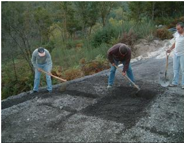
Início da construção do lisímetro no ASIC (2 m de comprimento x 1 m de largura)
