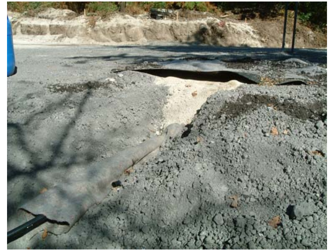
Tubagem, protegida por geotêxtil, de ligação do lisímetro ao reservatório de recolha do lixiviado
