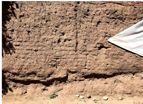
Fig.8 Muro de Estacionamiento erosionado
