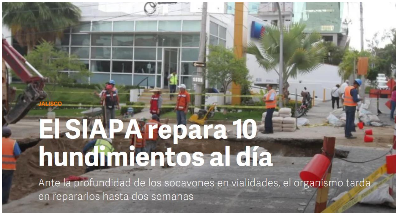
Figura 2. Consecuencias en temporadas de lluvia en AMG (El Informador, 2019).
