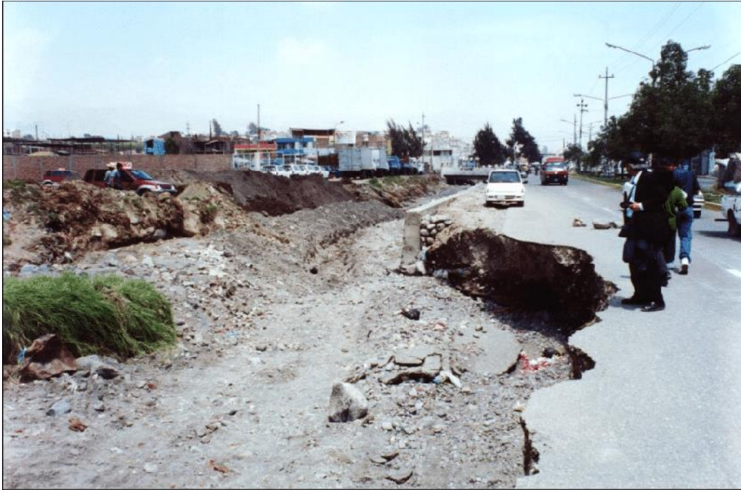
Figura 44. Erosión de pista urbana Arequipa (Kuroiwa, 2002).
