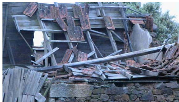
Visível estado de degradação das antigas instalações
