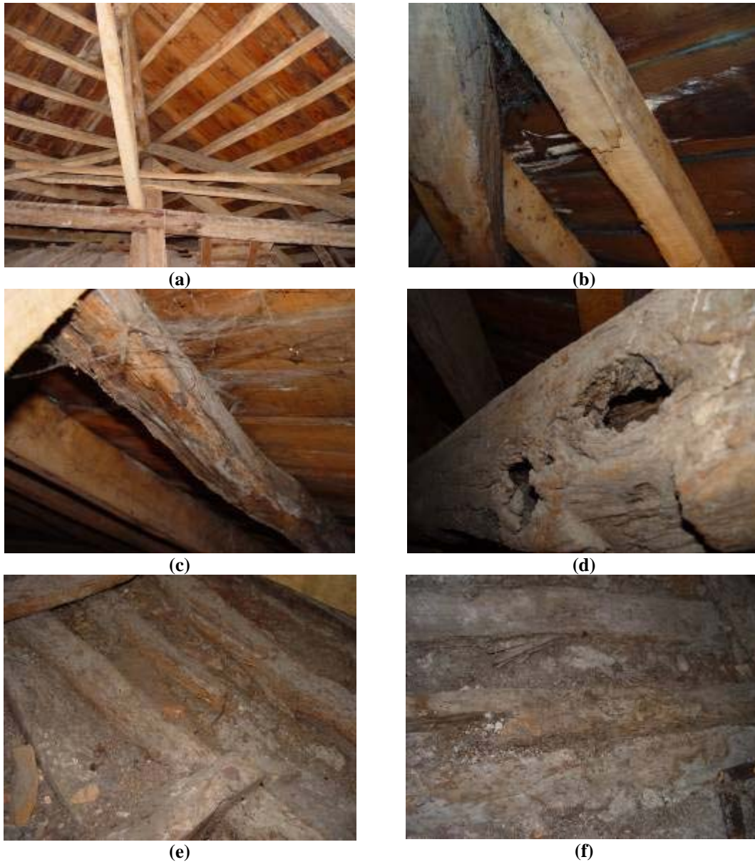
Figura 2 – Detalhes da cobertura existente: (a) complexidade do sistema estrutural; (b) presença de manchas de humidade; (c) deformação excessiva e podridão; (d) secção oca; (e, f) ataque generalizado das cambotas da abóbada principal
