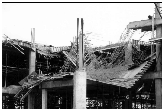
Figura 1 – Colapso do cimbra da cofragem durante a betonagem de laje.
