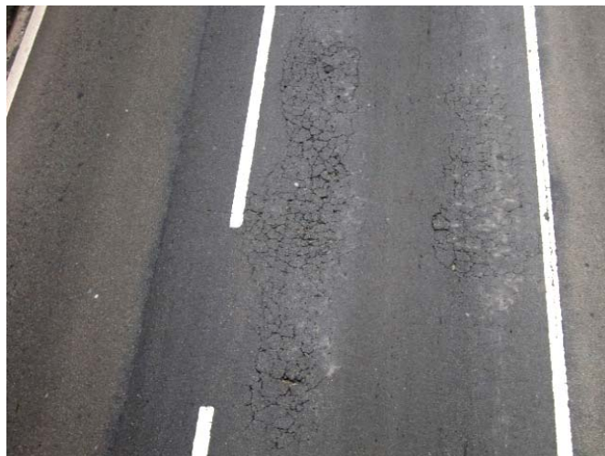
Foto 4 – Pavimento degradado em via urbana de elevada capacidade de tráfego
