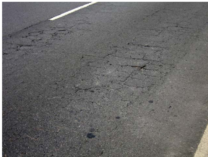
Foto 2 – Pavimento em estado de ruína
