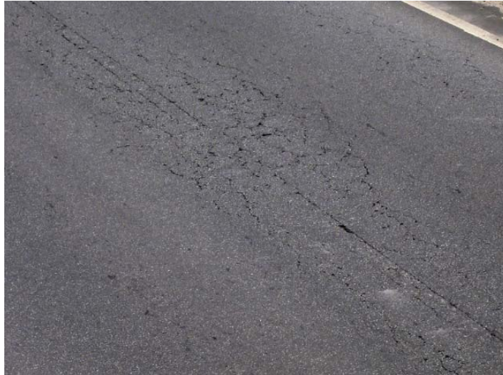
Foto 1 – Pavimento fendilhado (pele de crocodilo): estado de pré-ruína
