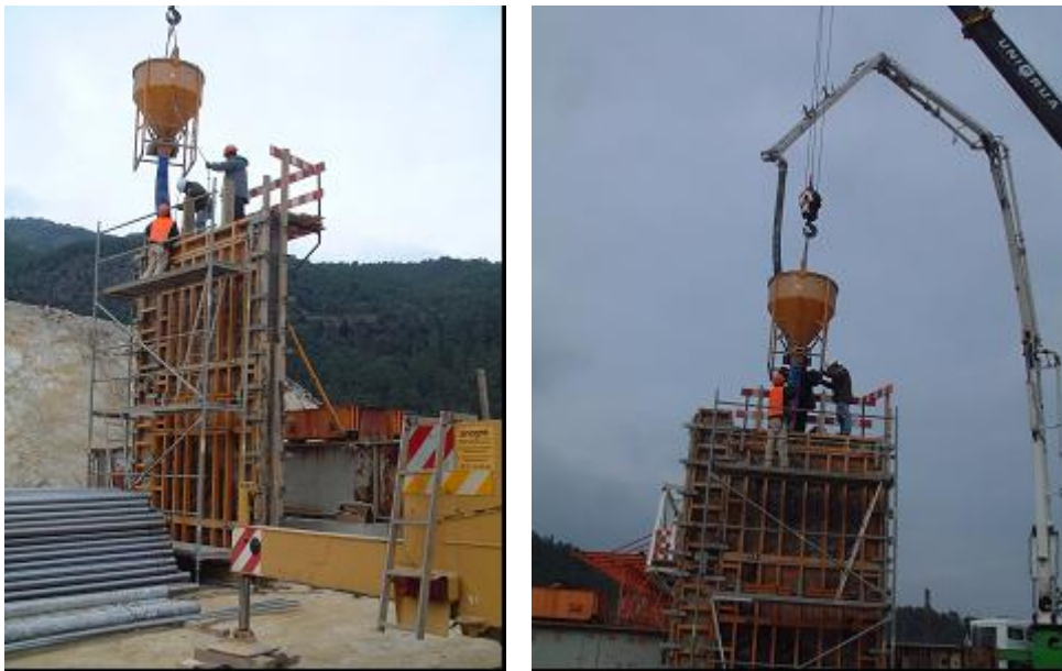
Figura 6 – Descarga do betão por balde e manga (à esquerda); bombagem do BAC (à direita).
