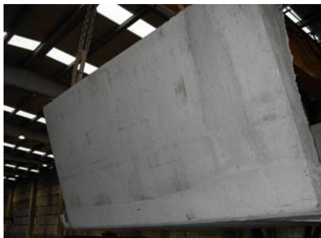
Figura 2– Junta de betonagem na peça betonada com BAC.
