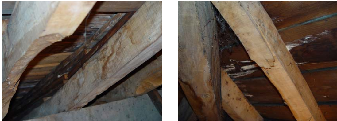
Figura 14 – Efeito da humidade nos elementos do forro. As manchas de humidade e a presença de fungos de podridão indiciam infiltrações antigas.
