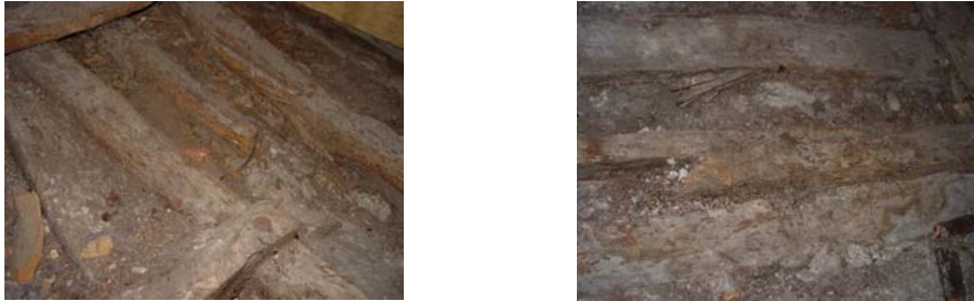
Figura 7 – Pormenores da madeira do ataque generalizado das madeiras e da irregularidade das secções provocada pelo mesmo, nas cambotas da abóbada principal.
