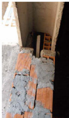
Figura 2.14: Situações potenciadoras de anomalias em alvenarias. Pontos singulares mal executados [9]
