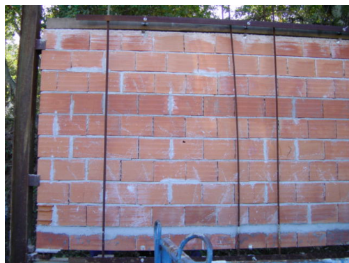
Figura 8.23: Vista geral da fissuração a 45 graus na zona esquerda da parede
