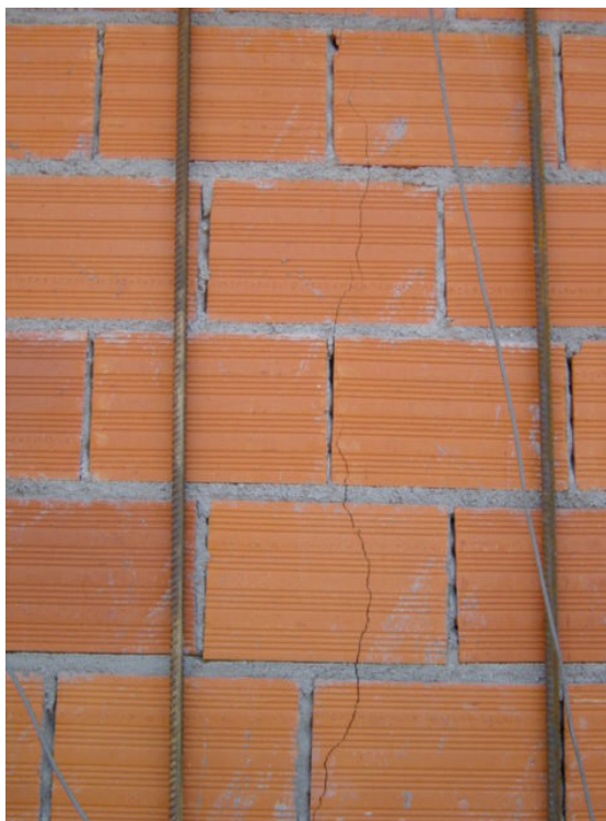
Figura 8.11: Aspecto geral da fissura situada a meio vão da parede entre a 4. a e a 8. a fiada
