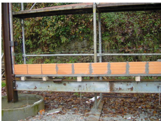
Figura 8.5: Viga inferior destinada à sustentação indirecta da parede e respectiva chapa de apoio
