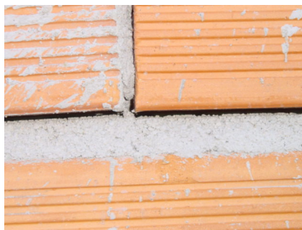
Figura 8.19: Pormenor da zona fissurada
