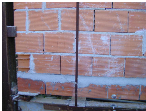
Figura 8.24: Detalhe da zona fissurada junto ao apoio esquerdo
