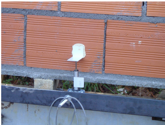
Figura 8.3: Equipamento para medição de deformações
