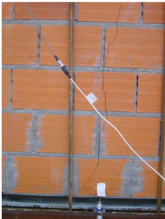
Figura 8.10: Aspecto geral da fissura situada a meio vão da parede entre a 1. a e a 4. a fiada
