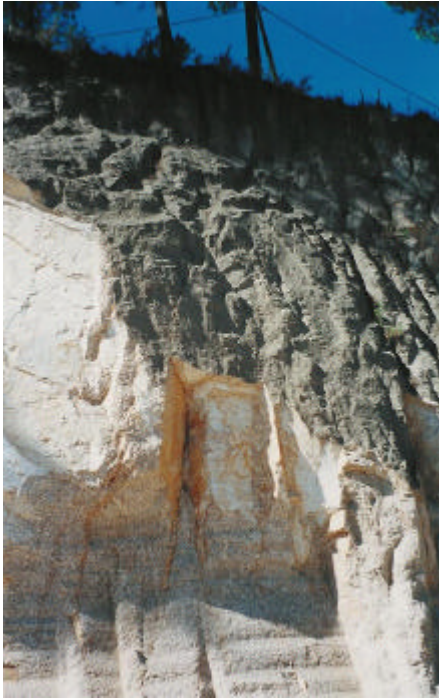
Fig. 2.18 - Zona de contacto entre o desmonte recente e inactivo. O material mais compacto é destacado através de pega de fogo apresentando arestas angulosas. No nível inferior o material é mais friável estando marcado pela extracção com escavadora. Ao centro é visível a ferruginização num plano de fractura natural.
