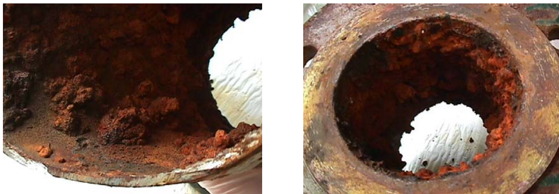
Figura 1.3 - Segmentos de tubagens da rede de distribuição de água potável com visível deterioração.
