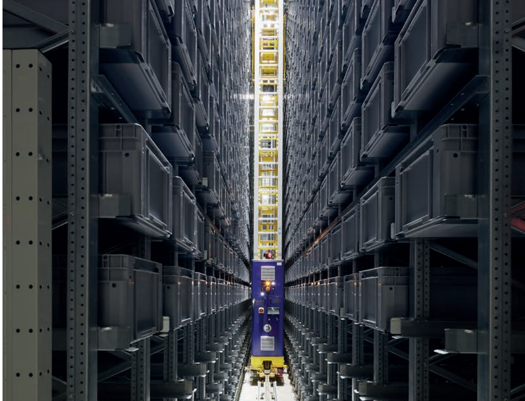
Robots halen in een razendsnel tempo de opgevraagde boeken en tijdschriften op in de nieuwe opslagvoorziening van de Kooperative Speicherbibliothek Schweiz in Büron
