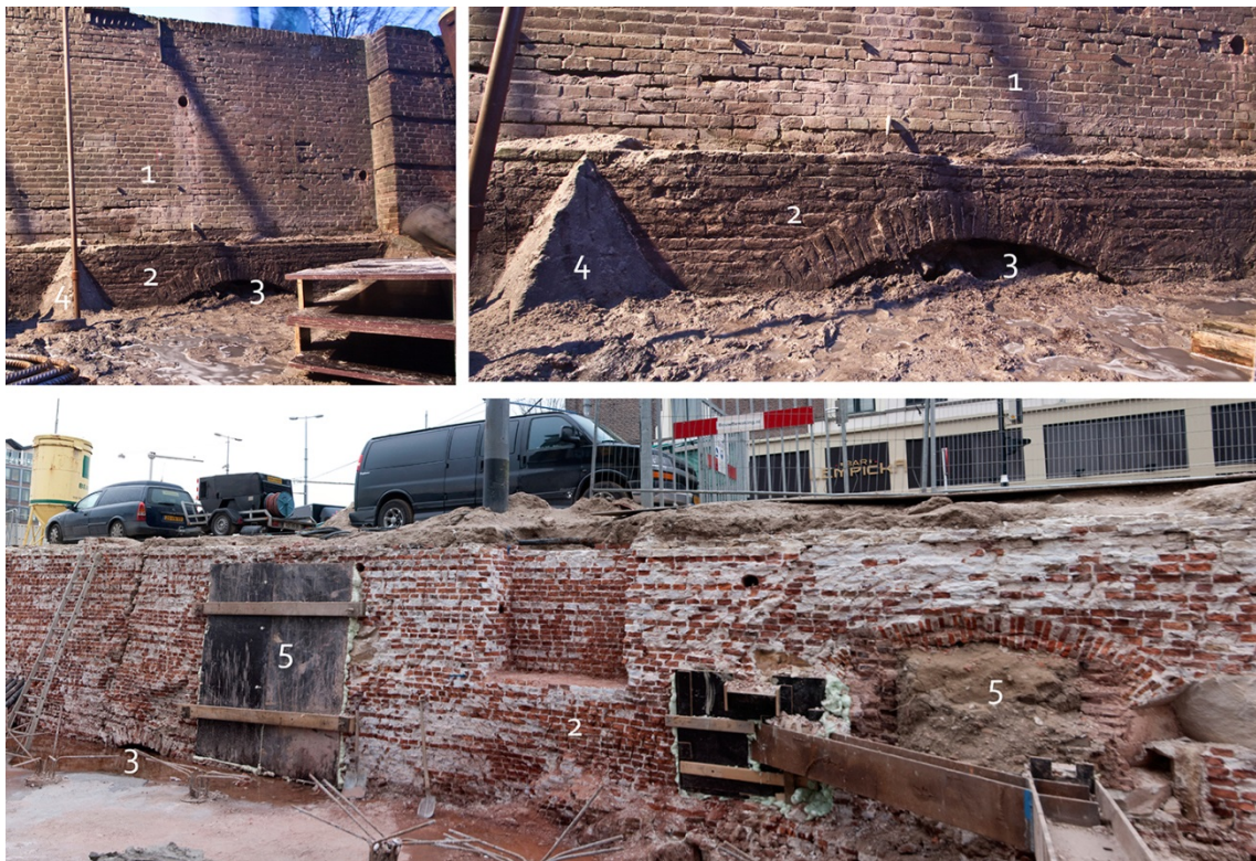
29 Tijdens de renovatie van de Hogesluis kwamen een aantal verborgen bouwsporen aan het licht. De 19de-eeuwse muur (1) bleek niet meer dan een klamp te zijn tegen de oorspronkelijke muur (2). Daarin waren (dichtgezette) gewelfbogen (5) en funderingsbogen (3) zichtbaar. Tegen de oorspronkelijke muur waren natuurstenen sierelementen (4) aangebracht.
