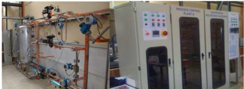
Figura 5. Planta de automatización de LACTI
