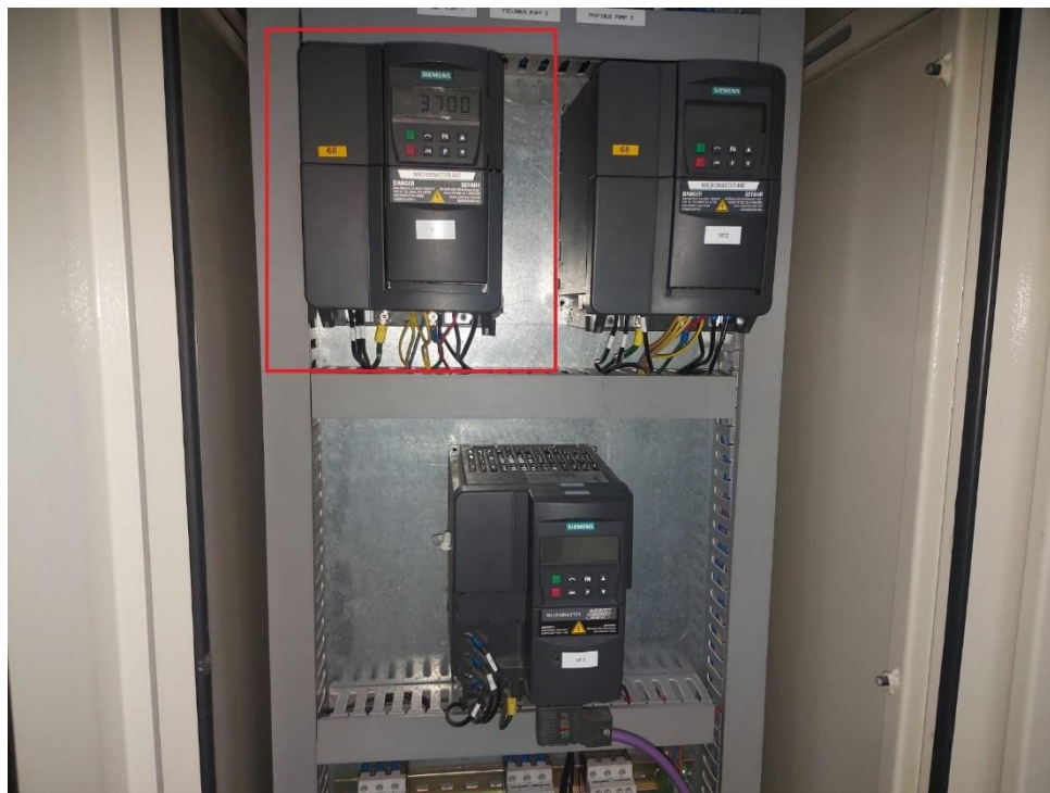
Figura 18. Variador de frecuencia.
