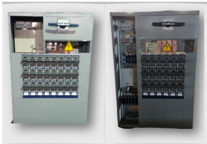
Figura 9 - Armários Fimartel - R630
