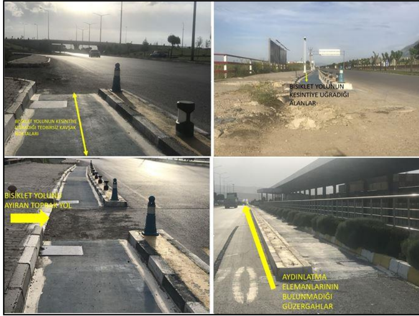
Şekil 3. Manisa mevcut bisiklet yolu güzergâhlarında tespit edilen sorunlu alanlar
