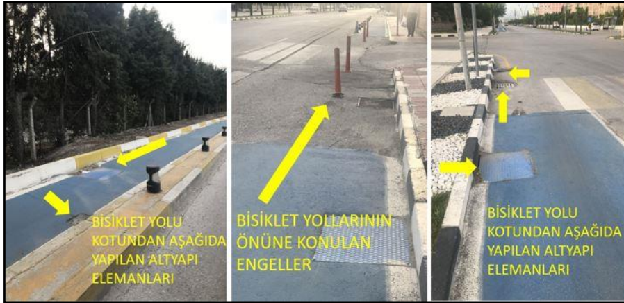
Şekil 4. Manisa mevcut bisiklet yolu güzergâhlarında tespit edilen sorunlu alanlar
