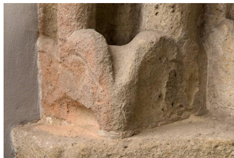
Fig. 5. Damage of the wavy archivolt base
