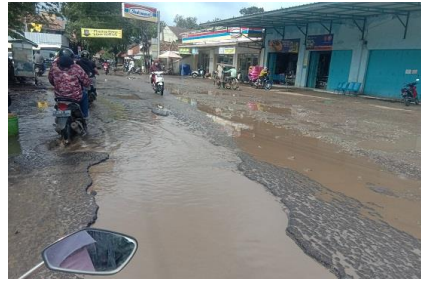
Jalan Raya pertigaan Sasak Bubur, Kecamatan Cihampelas, KBB yang berlubang besar (dara.co.id, 2021).
