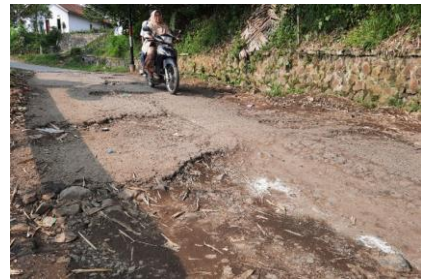
Jalan rusak di wilayah Desa Mukapayung, Kecamatan Cililin, Kabupaten Bandung Barat (PikiranRakyat.com, 2022)
