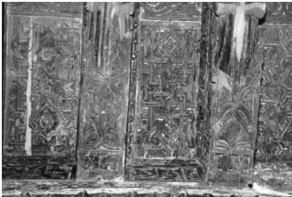
Fig. 14. Toledo. Casa palacio del Temple. Cobijas del arrocabe del lado sureste de la sala n.º 2.
