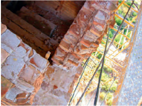
Fig. 12. Desmontaje manual de elementos con peligro de caída.
