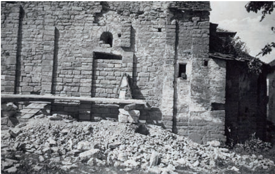
Fig. 6. San Caprasio en el proceso de demolición de las naves y elementos añadidos en edad moderna. 1955. Archivo familiar empresa Tricás.
