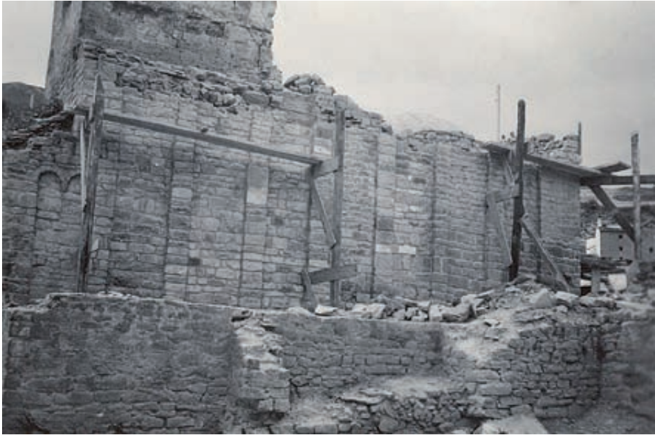
Fig. 5. San Caprasio en el proceso de demolición de las naves y elementos añadidos en edad moderna. En el reverso aparece la fecha de la imagen: 14-1-1955. Archivo familiar empresa Tricás.
