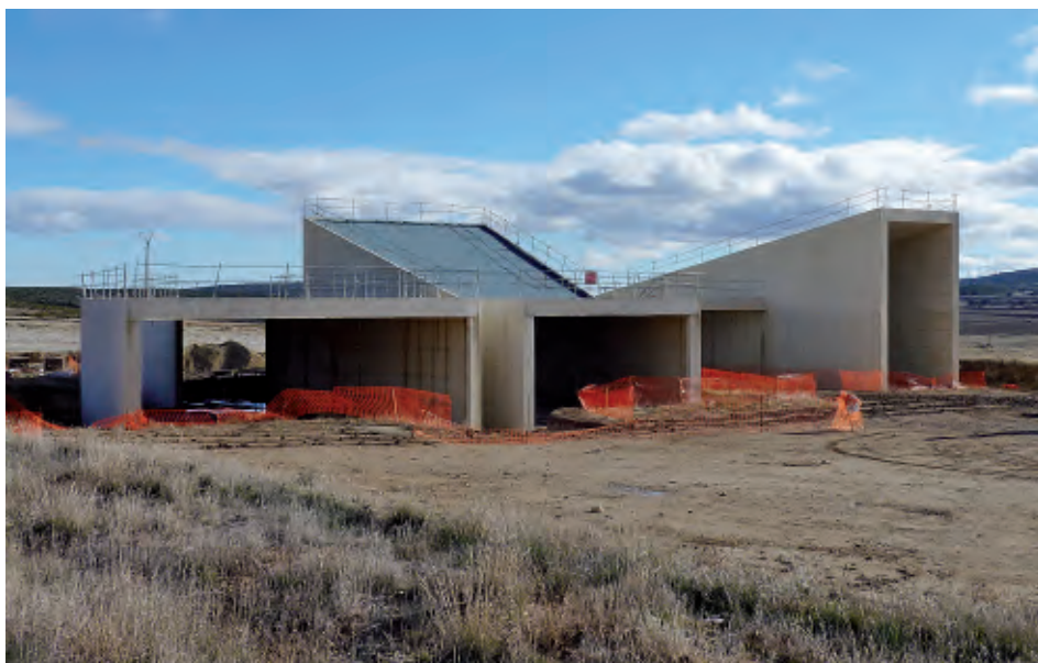
Fig. 13. Estado de las obras del nuevo Museo del Grabado de Fuendetodos en marzo de 2011.
